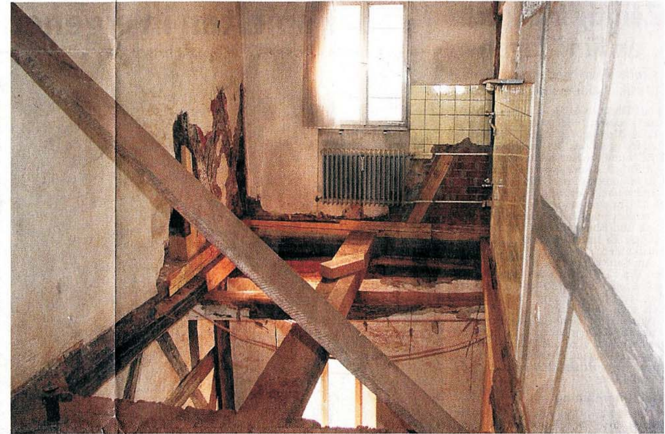
Das Adelsdorfer Schloss muss dringend saniert werden. Im Haushaltsplan der Gemeinde stehen dafür 574 000 Euro bereit.
